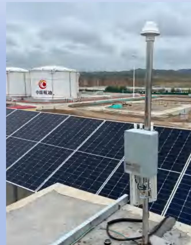
中国航油青海分公司西宁油库智能防雷项目
